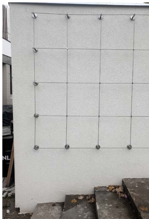
Zdjęcie 8.4.3 Linki stalowe na elewacji
