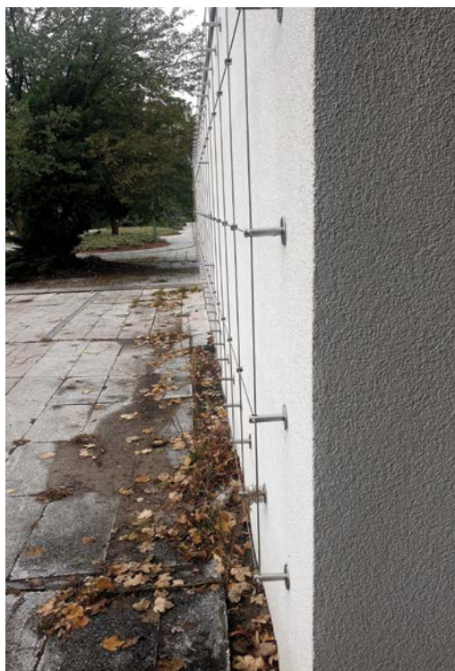
Zdjęcie 8.4.2 Linki stalowe na elewacji
